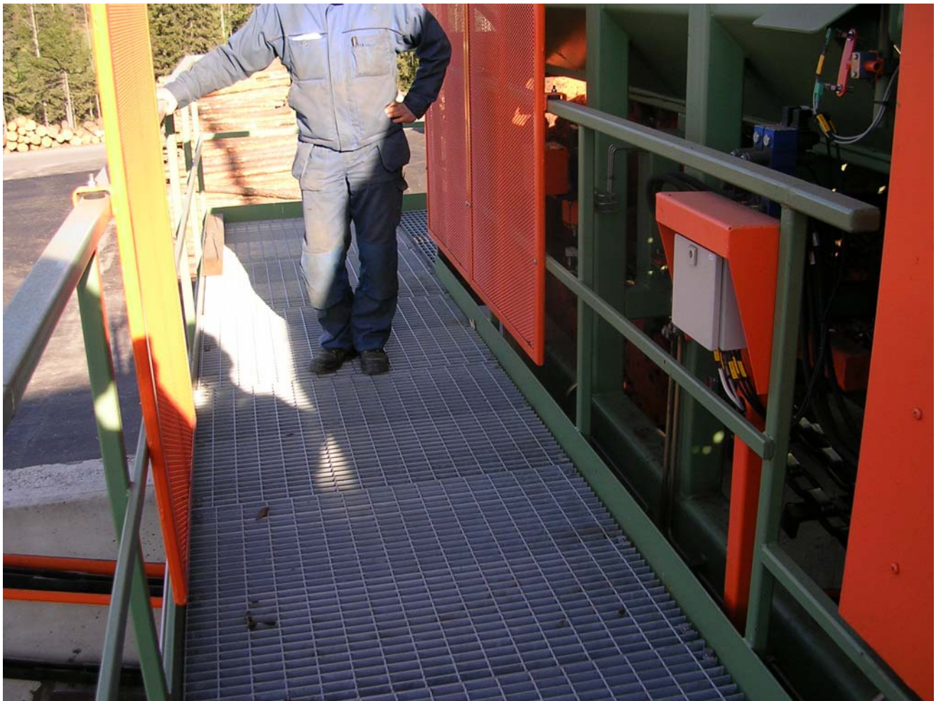
C 1. Timmerintaget: Skydd som är svåra att montera och demontera eftersom man måste sträcka sig in bakom skyddet för att komma åt muttrarna.
