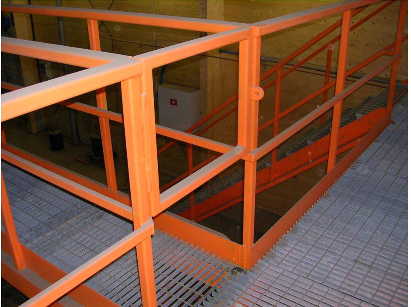
A3. Plattform ovanför barkmaskin: Tvåledigt räcke med grind som inte var godtagbart fastsatt/låst . Lätt att krypa igenom grind/staket.
