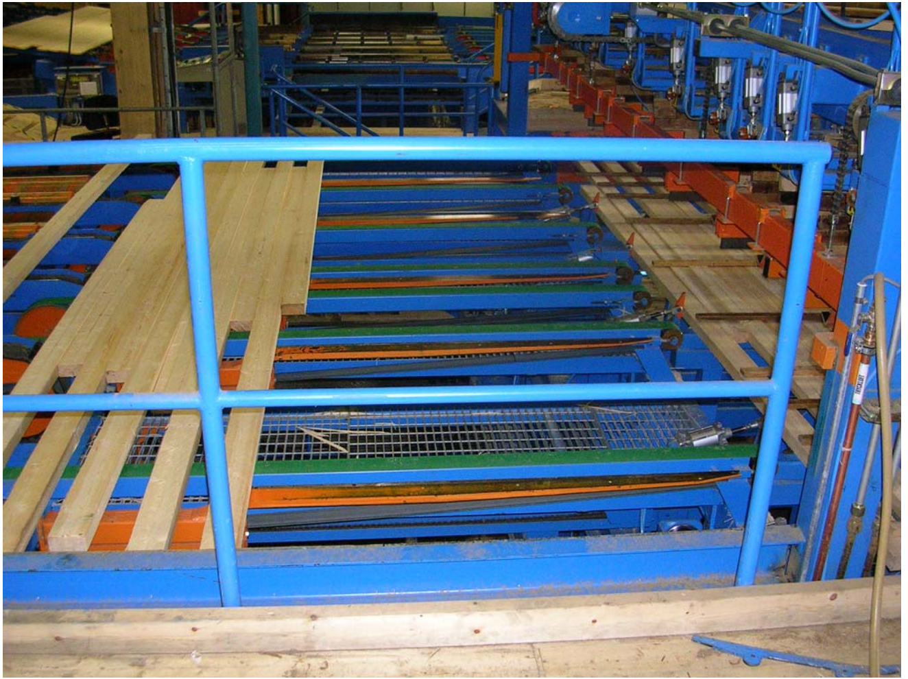
A 14. Råsorteringen: Inmatningsdelen framför ströläggaren har förskyddats med ljusridå på andra sidan. På denna sida finns enbart tvåledigt räcke som skydd som man lätt kan krypa igenom.
