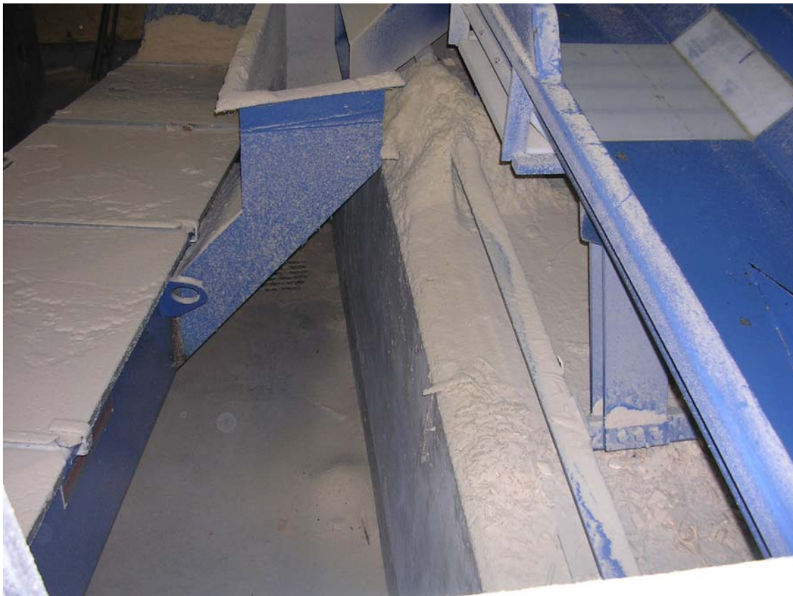
E 2. Rum för spånhantering: Fint damm ligger i stora mängder utanpå transportörerna. I transportörerna finns samma damm, med eventuell risk för dammexplosion.
