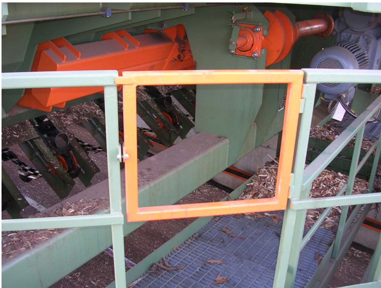
A1. Området under stockvändaren: Lätt att krypa igenom staket/grind. Öppningar i skyddet är för stora, och höjden på skyddet 1,1 m är för lågt, eftersom man lätt kan kliva över till gallerplanet på insidan. Det är för lätt att öppna grinden med ett enkelt verktyg.
