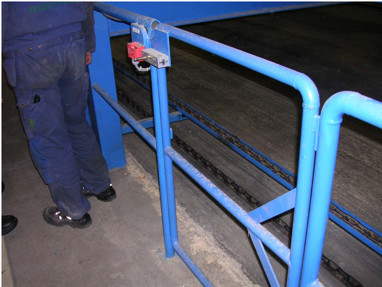
A7. Bottenplanet i råsorteringens fackdel: Tvåledigt räcke med grind som var förreglad. Lätt att krypa igenom grind/staket in i riskområde.
