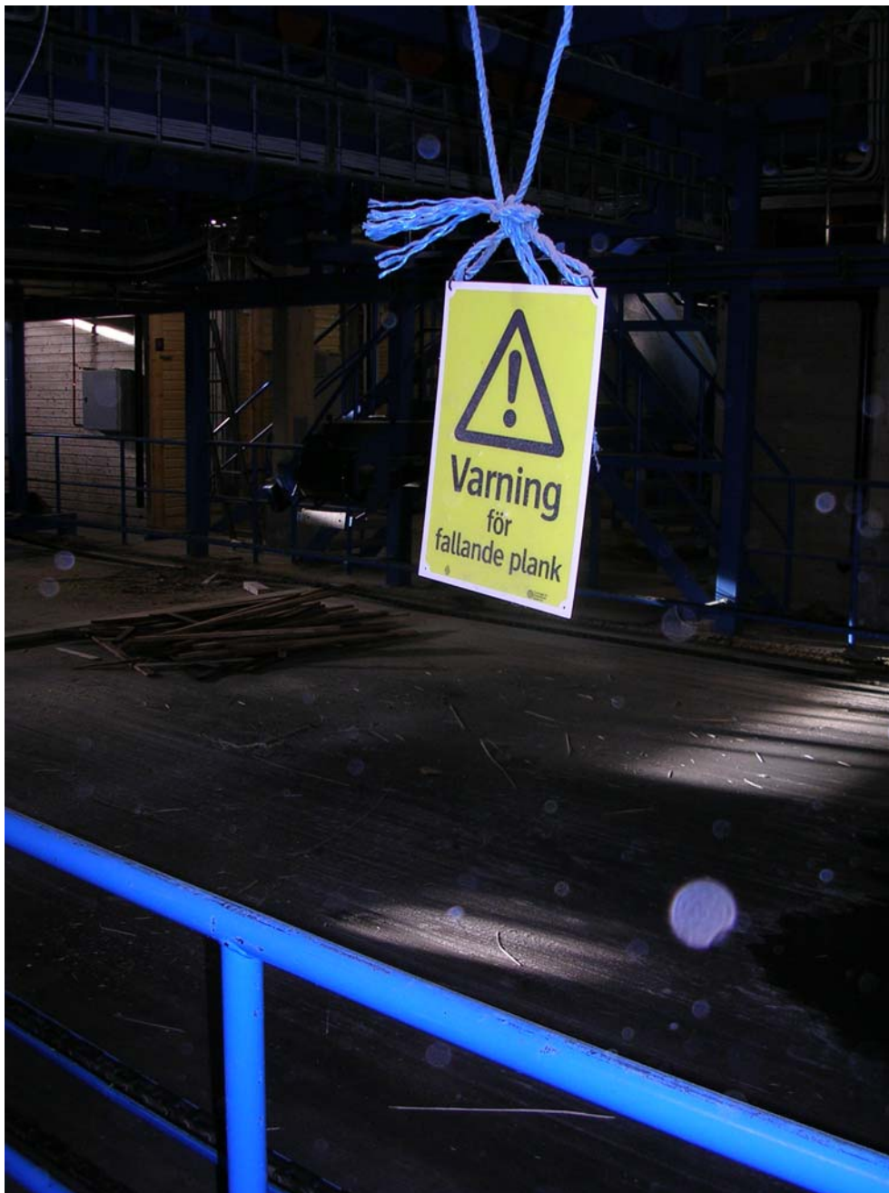
A 10. Tvåledigt räcke med varningsskylt. Lätt att krypa igenom räcke. Var kan plankan hamna?
