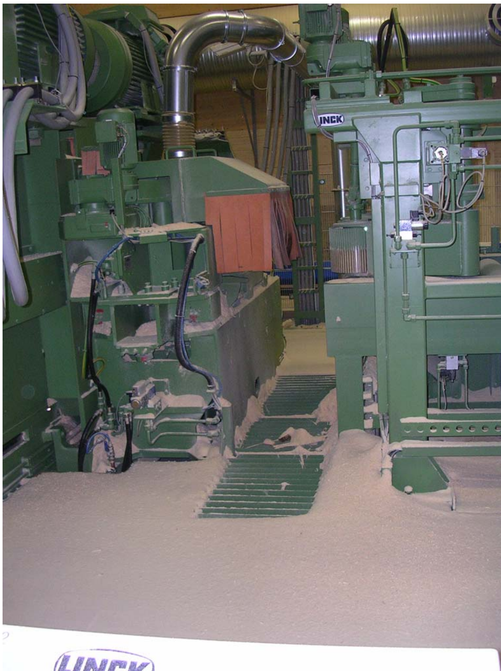
E 1. Såghuset: Vissa delningsmaskiner sprider ut mycket damm och känd teknik för att minska dammspridningen tillämpas inte. Risk för dammexplosion i och utanför sågmaskinen.
