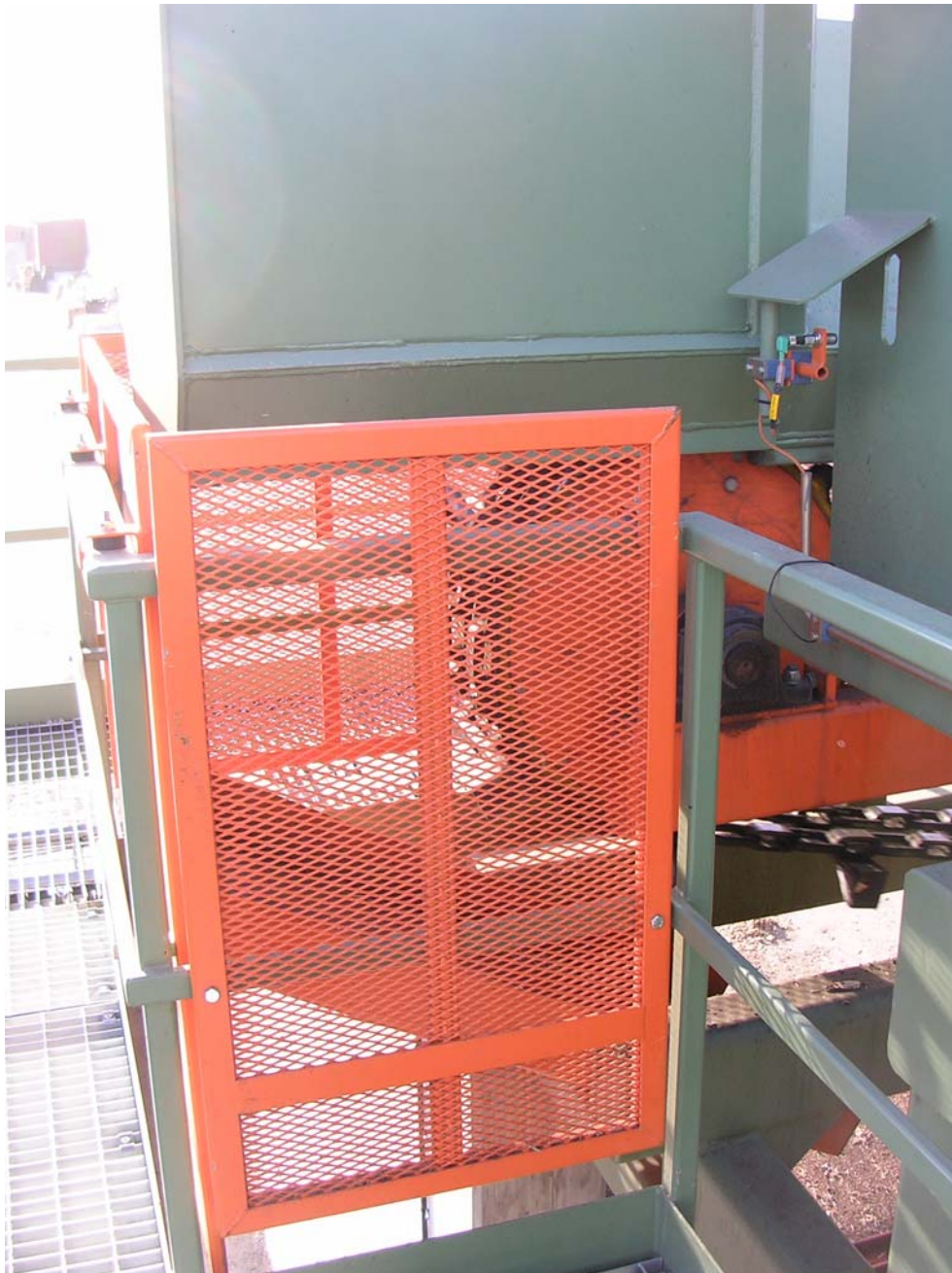
K 1. Kedjevändhjul vid tvärbord: Man kan med handen nå in till vändhjulet och skadas.
