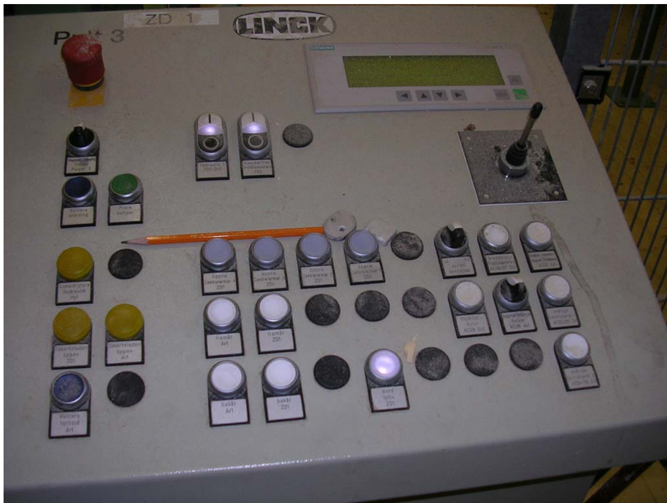
H 1. Såghuset: Display är dammbelagd, vinkeln på displayen, färgkombination och reflexer gör den svår att avläsa.
