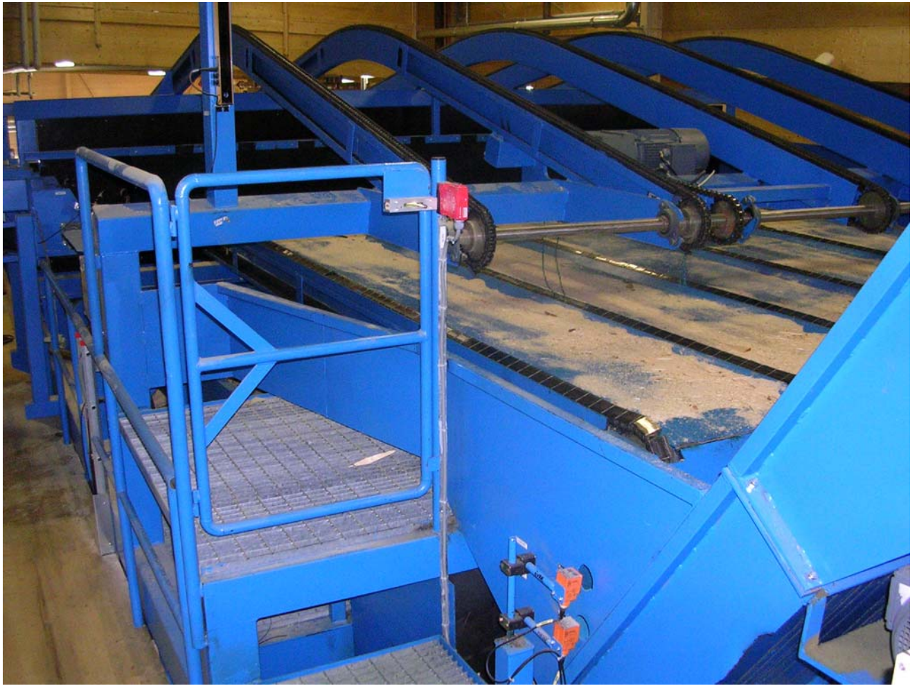
A 13. Råsorteringen: Förreglad grind, men man kan mycket lätt kliva upp på transportören vid sidan om grinden om man använder durkplanet som trappsteg.
