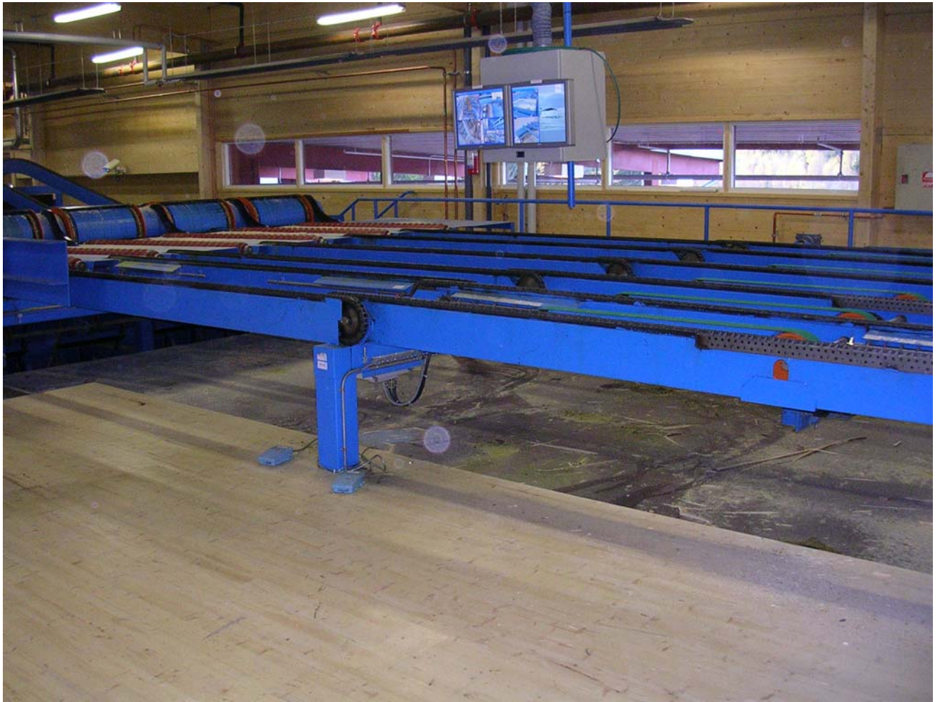
A 5. Råsorteringen: Ljusridå skyddar för inpassage ovanför transportkedjorna, men man kan lätt krypa in under kedjetransportörerna.
