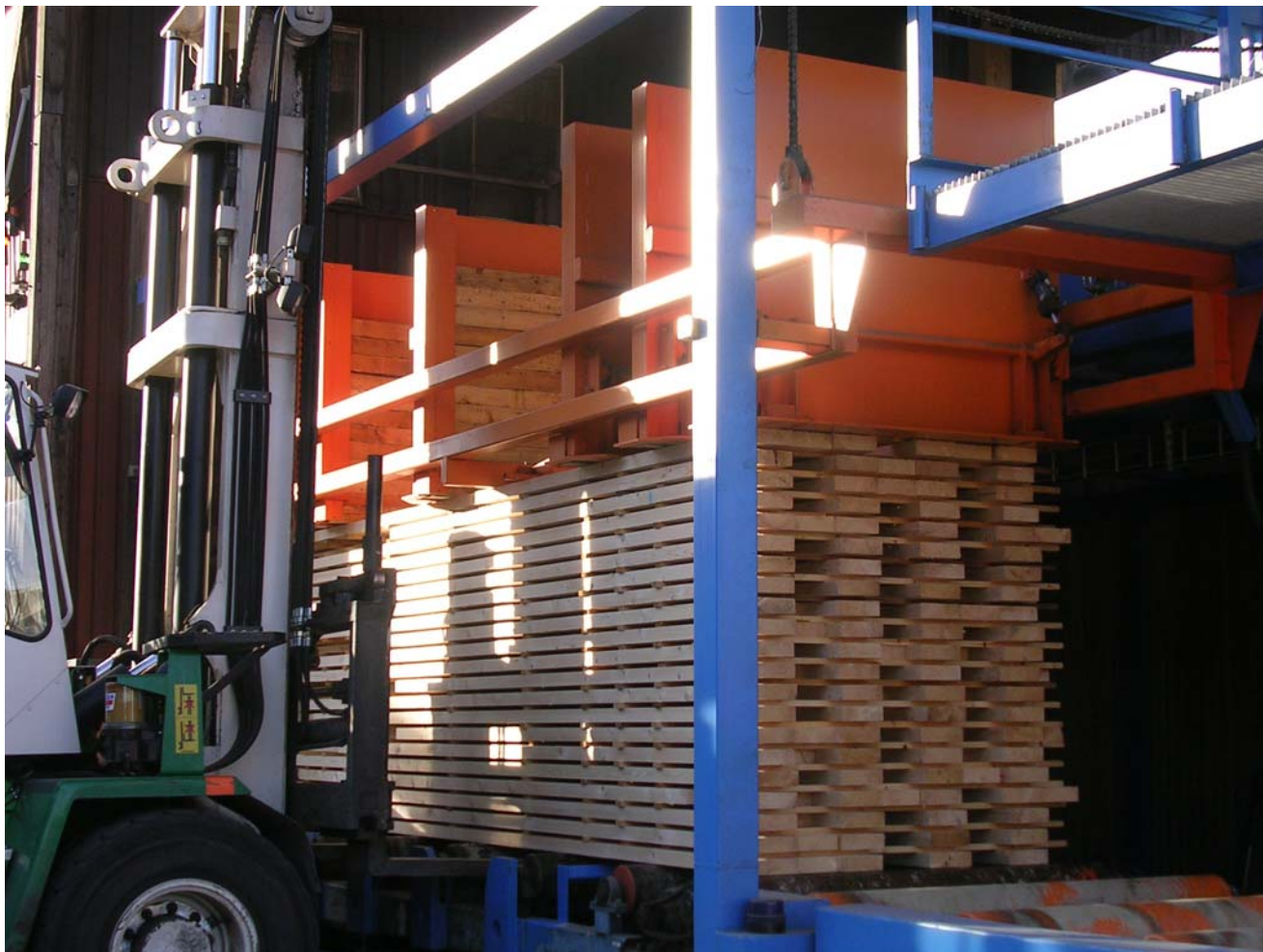
A9. Vändhjul för ströpaket: Rörelsen startas automatiskt och har ingen godtagbar skyddsfunktion.
